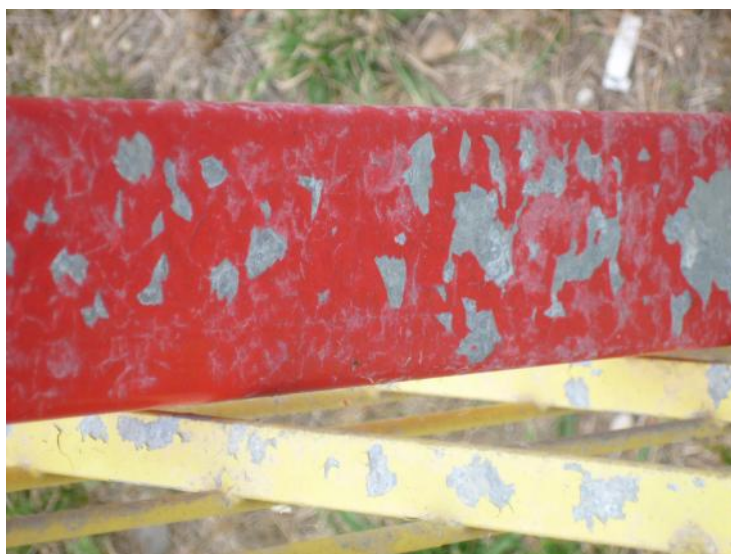
wadliwie nałożona powłoka proszkowa na ocynk zanurzeniowy
